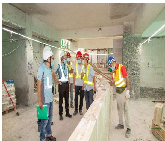
Visita inspectiva de segurança e saúde ocupacional a estaleiros da construção civil
