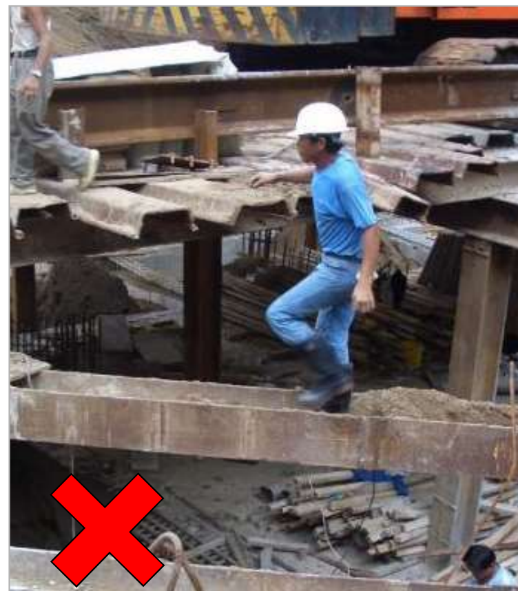
没有使用或提供安全的通道
